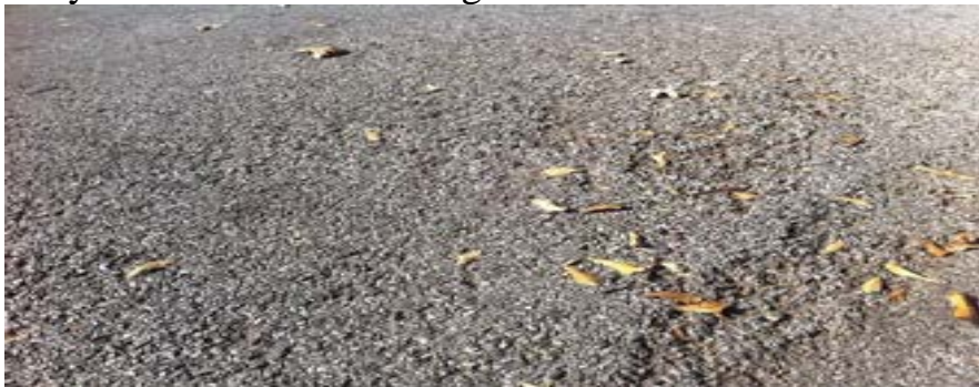
Fig. Raveling (very porous asphalt)
