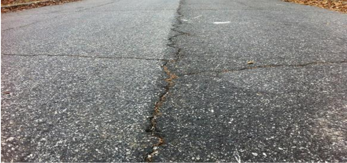
Longitudinal (Linear) Cracking
