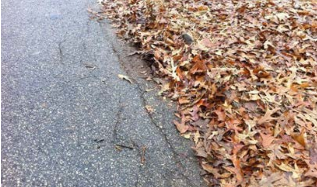
Fig. Edge Cracks
